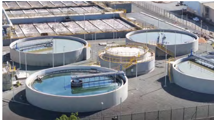
Planta depuradora de Madinah-3, Arabia Saudí
