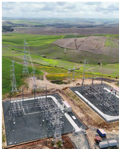
Subestación eléctrica de Carmona. Sevilla, España
