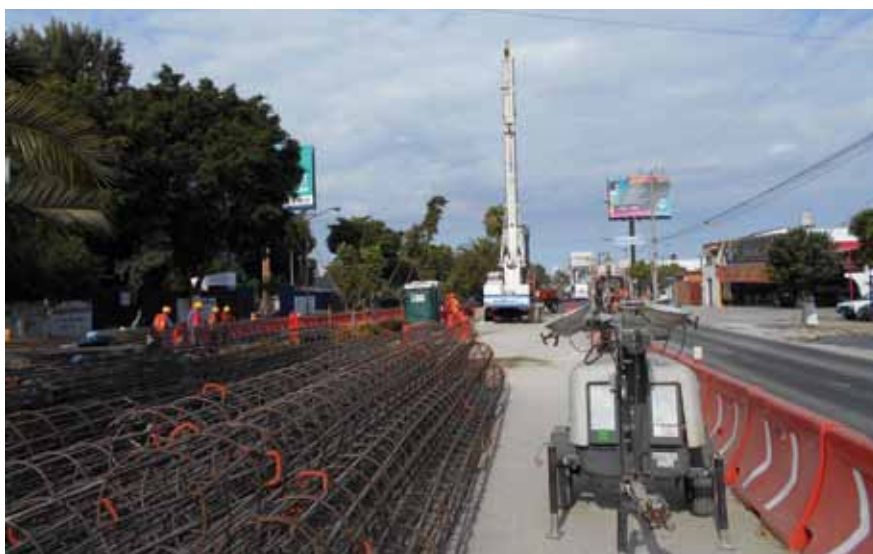
Preparación de pilas en la obra del tren ligero de Guadalajara (OHL)
