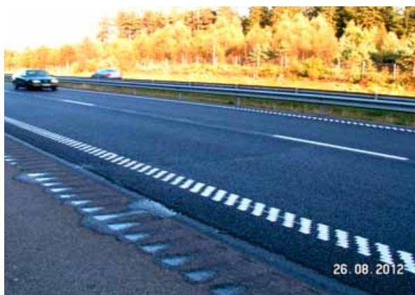
Junta en capa de microaglomerado producida por parada en el extendido.
