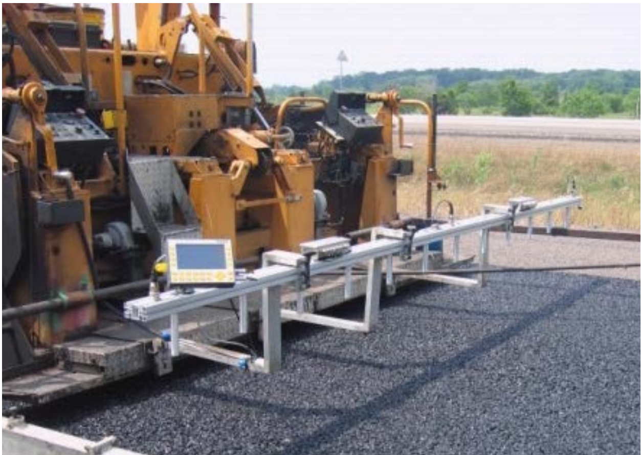
Infrared sensor bar system / Sistema de sensores IR montado en barra, Tejas, EEUU.
