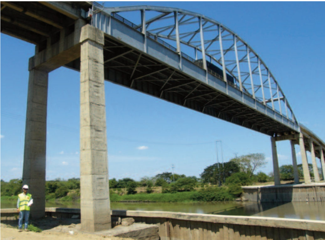
Vano principal del Viaducto de Calamar, puente de la ruta 25 sobre el Canal del Dique, canal navegable que une el río Magdalena y la Bahía de Cartagena
