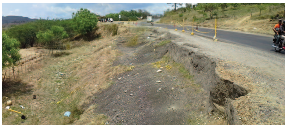
Deslizamiento activo en arcillas expansivas al norte de El Carmen de Bolívar que ha provocado que el talud de relleno izquierdo haya tenido numerosas caídas, habiendo sido necesario el rectificando del eje de la carretera actual
